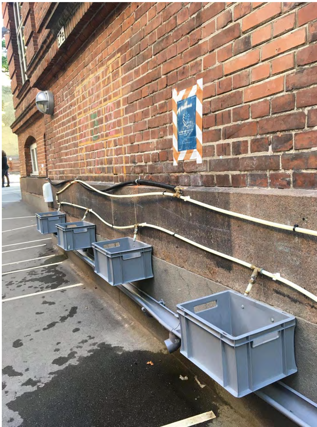
Lavamanos instalados para el regreso a clases en una escuela en Copenhague, Dinamarca. © Tomado de @WesthOlsen
